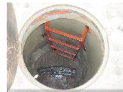
Колодцы и резервуары
