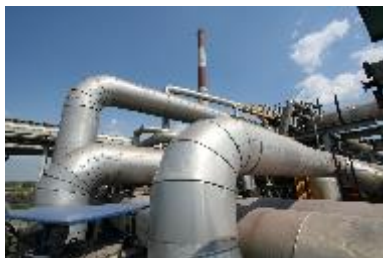
Технологическое оборудование, тепловые сети
