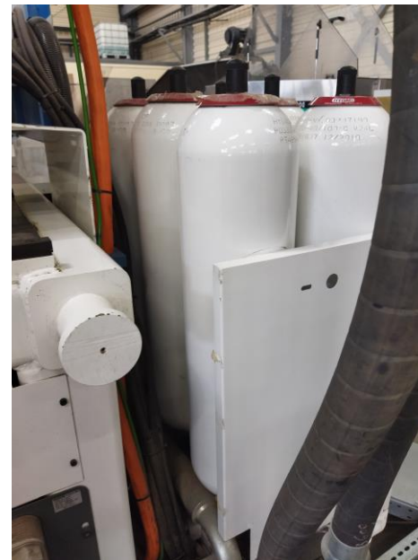
Батарея гидроаккумуляторов в гидросистеме термопластавтомата
